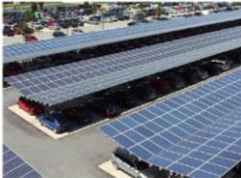
Panneaux photovoltaïques sur toits
