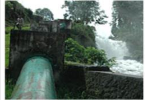
Installation hydroélectrique de 5MW
